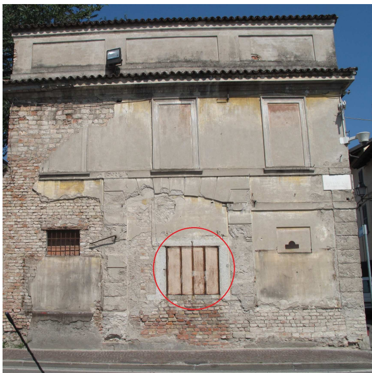
Foto 5 Si evidenzia la finestra aperta successivamente l'edificazione della facciata.
